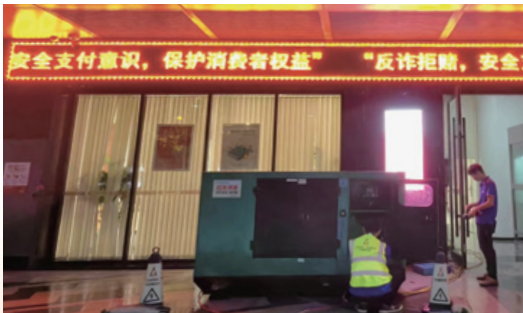
● 廣東分公司為銀行網點機房提供應急發電保障服務
