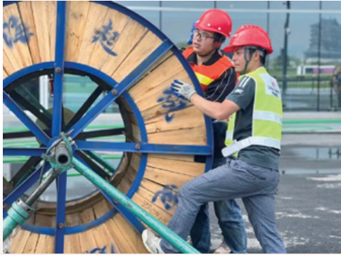
● 四川分公司大運會通信和供電保障作業
