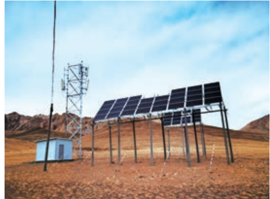
▲ 日喀則光伏通信基站
