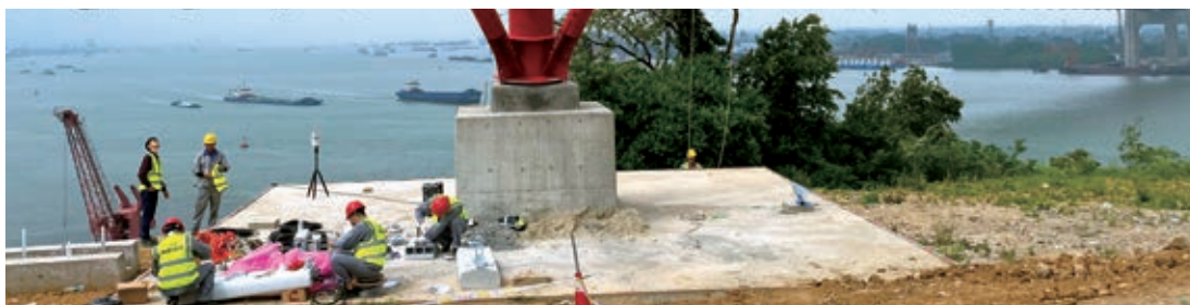
▲ 利用跨江220千伏電力塔掛載通信天線
