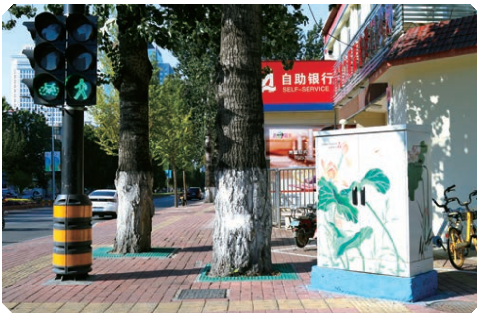
▲ 交通信號燈備電櫃
