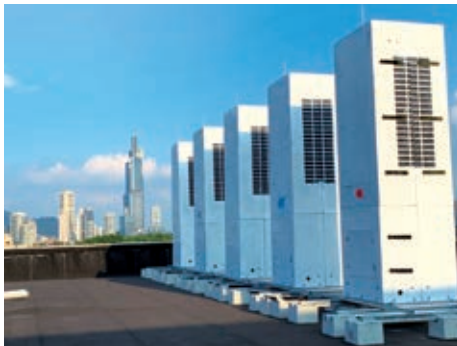
▲ 江蘇省委大院樓頂5G設備部署
