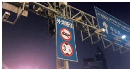
▲ 採用城區高架橋龍門架同步完成4G+5G覆蓋
