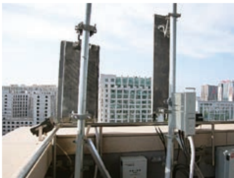
▲ 河南省政府大樓樓頂5G基站部署
